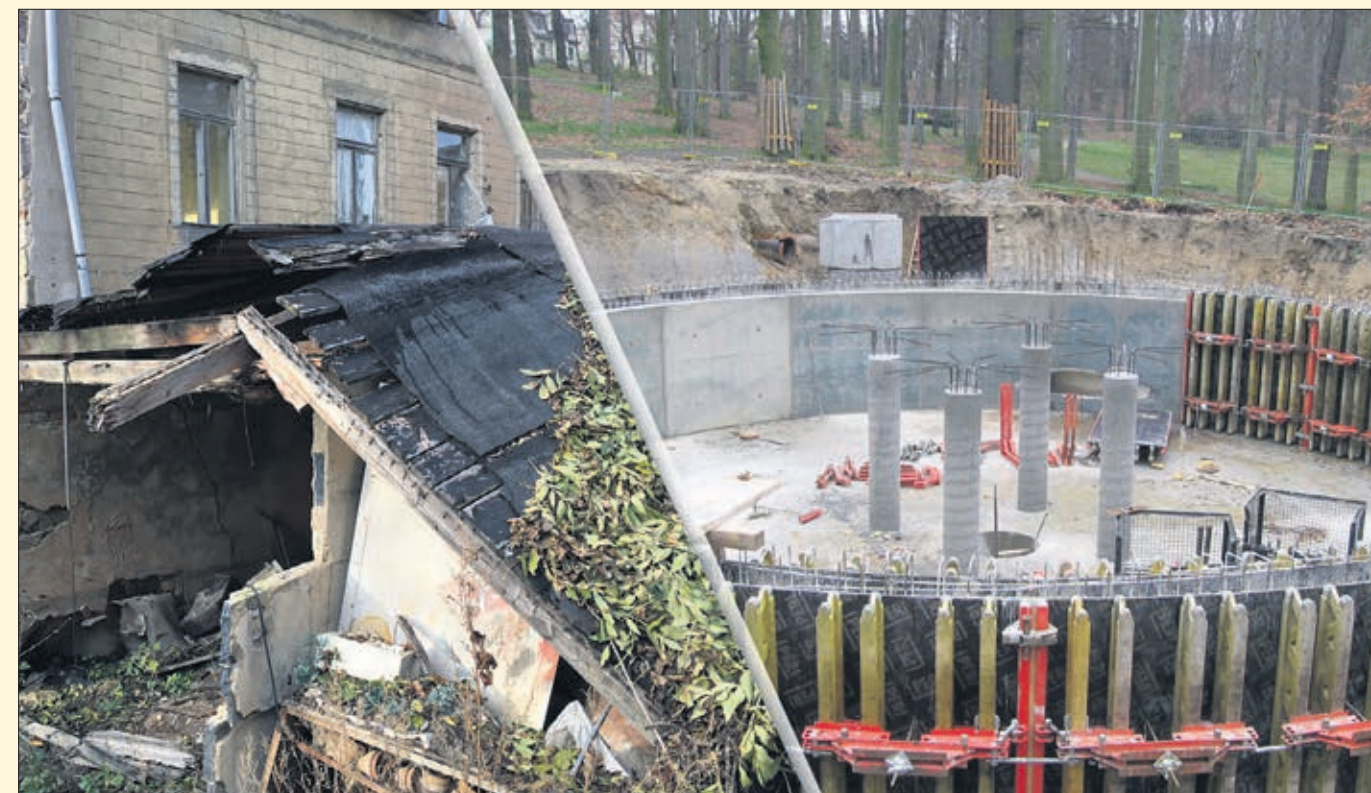
Noch ziert eine Ruine die Dresdener Straße. Zukünftig soll diese einem Regenrückhaltebecken weichen, um die Hochwassersituation in Oschatz einzudämmen.
