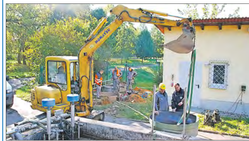
Bereits im Oktober erfolgreich abgeschlossen wurde der Umbau der Zulaufpumpstation der Kläranlage Naundorf. Die im Jahr 2005 in Betrieb genommene Pumpstation wurde einer Sanierung unterzogen.
