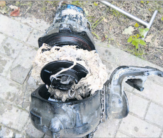
Aus dem Arbeitsalltag der Zweckverbändler: Deutlich zu erkennen – die Pumpe hatte gegen die reißfesten Feuchttücher keine Chance.
