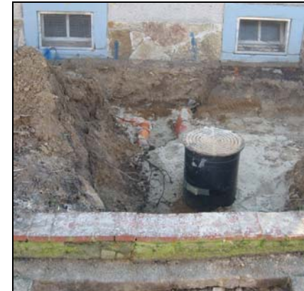
Hausanschluss mit Kontrollschacht
